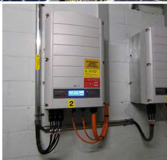
Wechselrichter im Kellergeschoss
