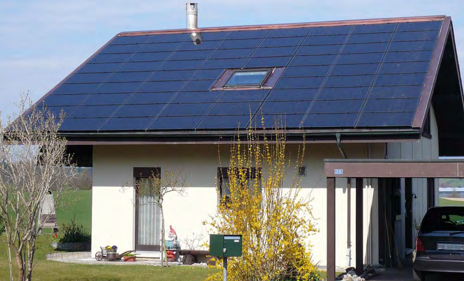
Dachintegrierte PV-Anlage auf einem Einfamilienhaus
