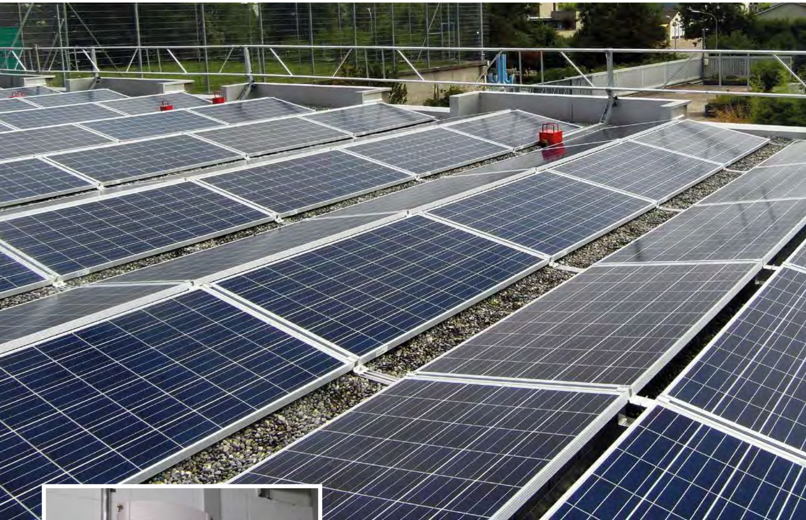
Solarmodule mit Ost-/Westausrichtung auf einem Flachdach
