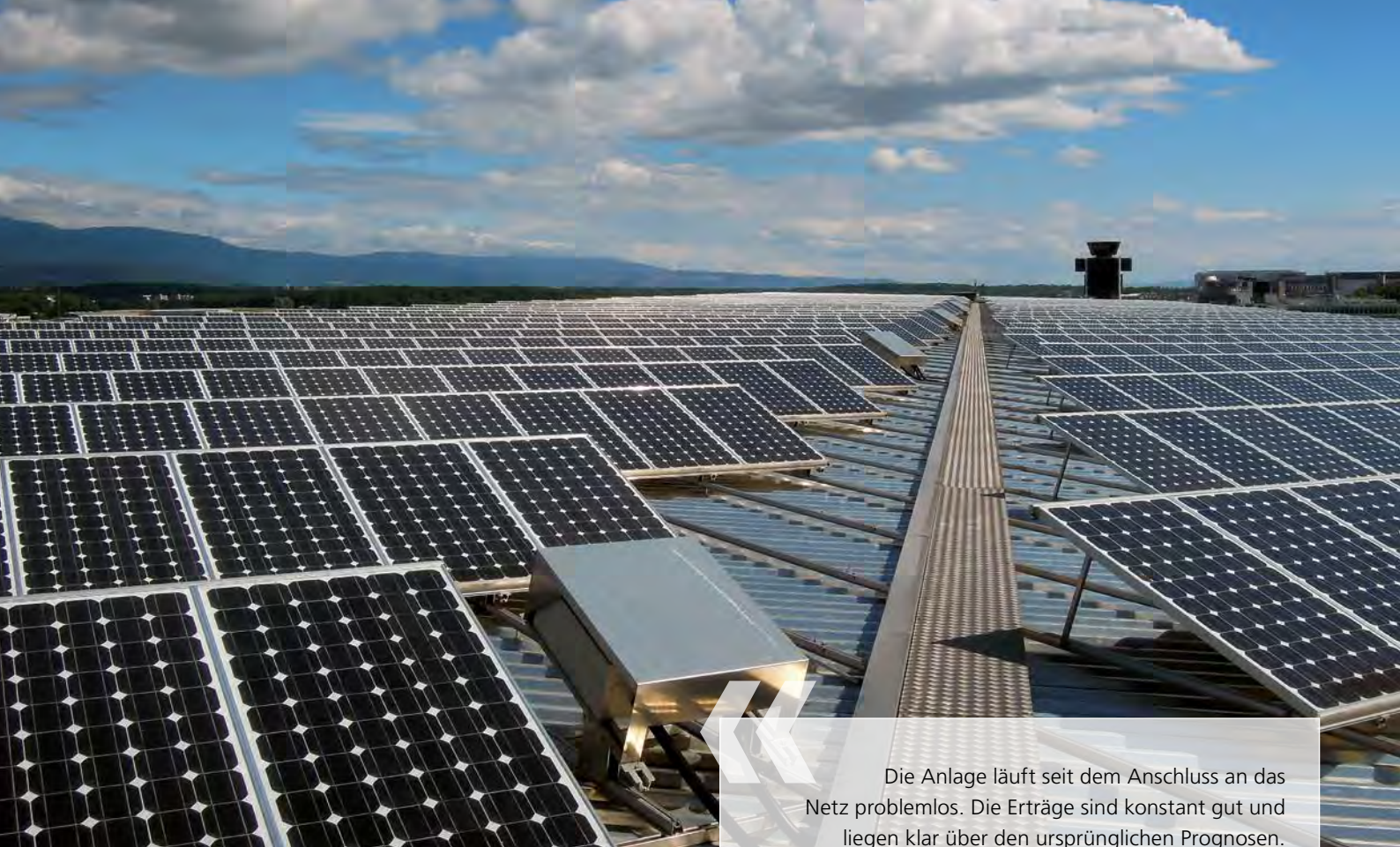
PV-Anlage der Edisun Power beim Flughafen Genf
